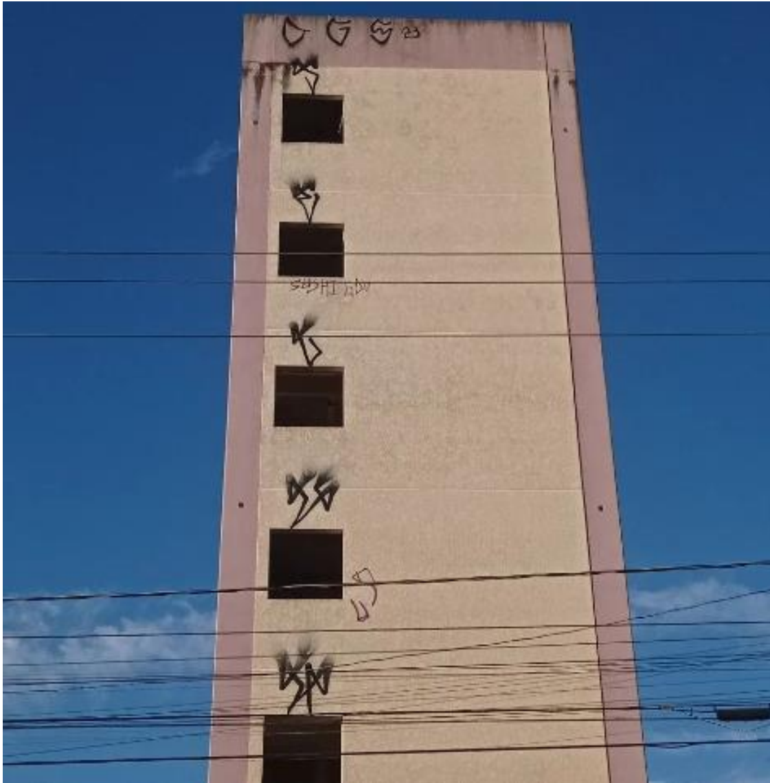
FIGURA 64: SELVA – PIXAÇÃO EM JANELAS
