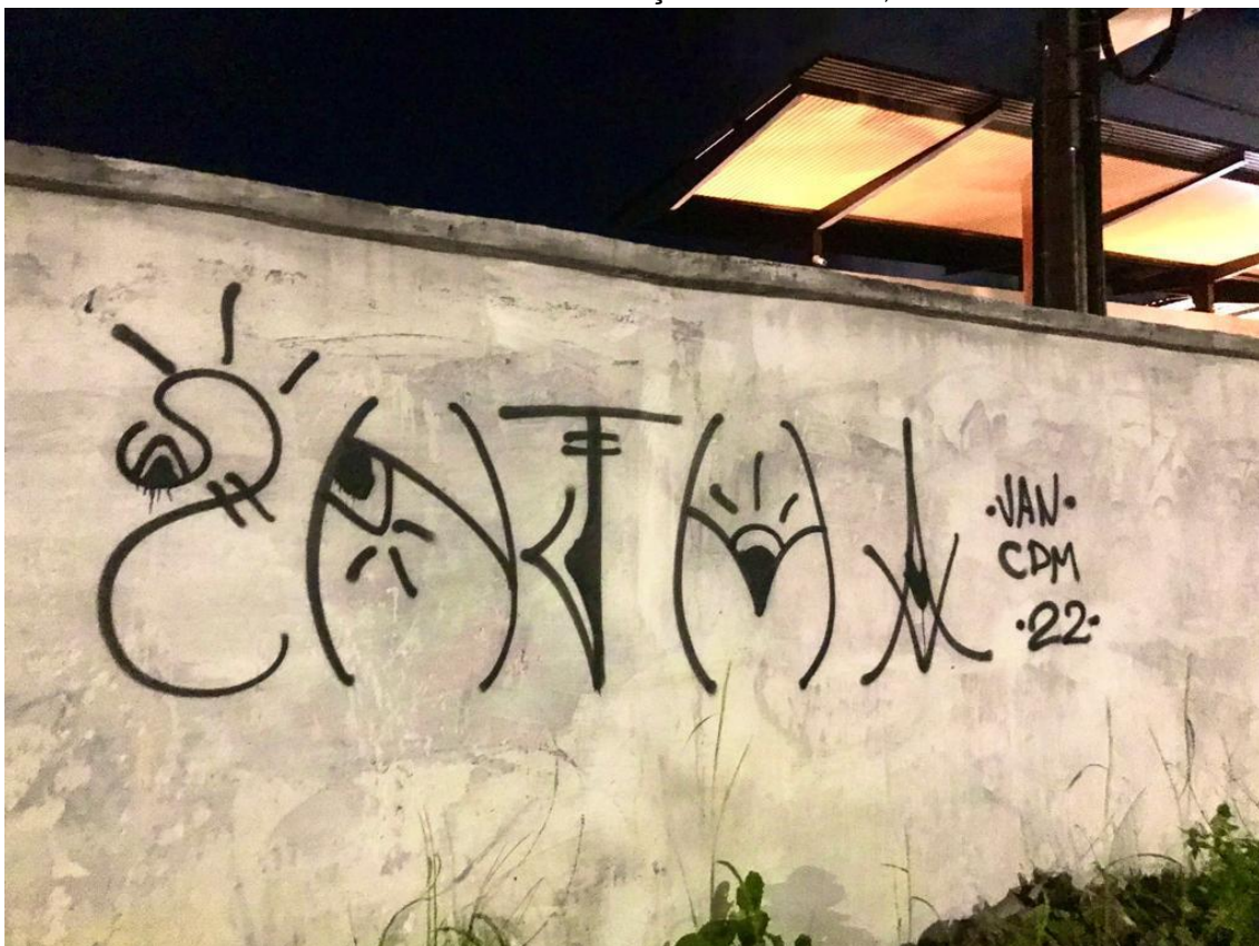
FIGURA 77: INJHA - PIXAÇÃO SOB MURO, 2022.
