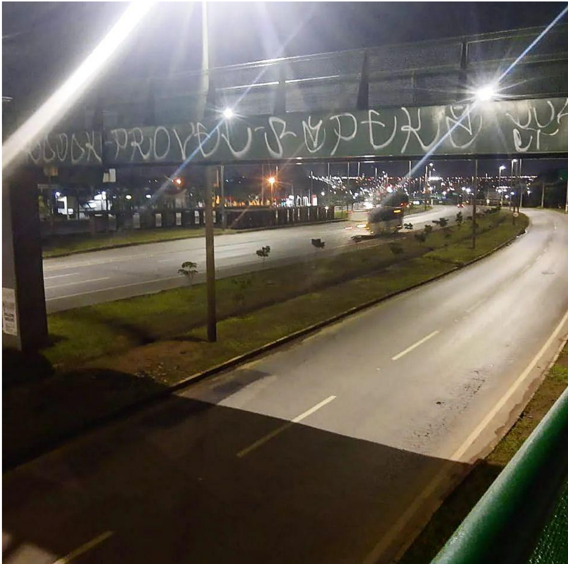
FIGURA 71: SAPEKA – PIXAÇÃO EM PONTE I
